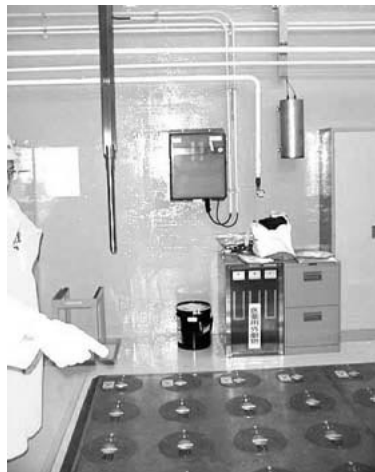
写真3 新燃料貯蔵室に設置した中性子センサ(写真右上の円筒容器)
